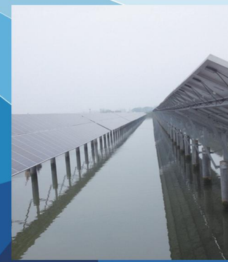
渔光互补光伏支架
