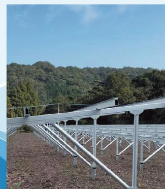
地面光伏支架
