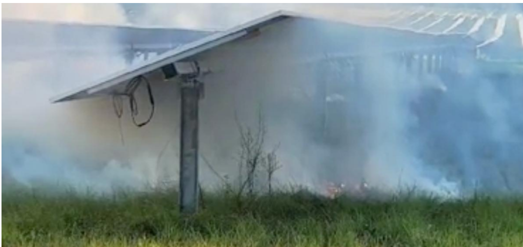
图36：现场草火，可能由电弧故障引发，产生浓烟，可污染并穿透光伏系统，潜在造成长期可靠性风险。
