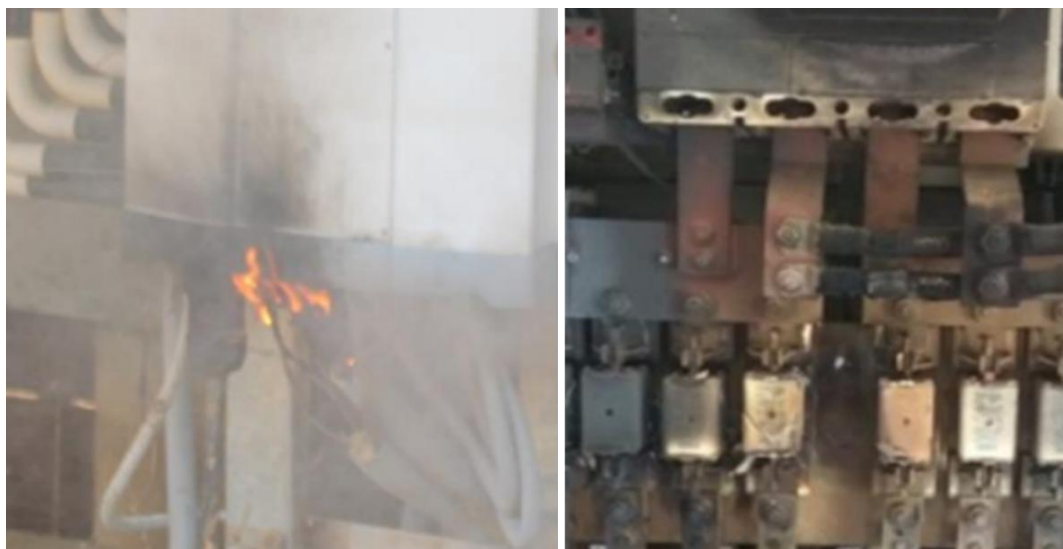
图32：在受洪水影响的太阳能电站对逆变器进行火灾攻击并烧毁SCB。
