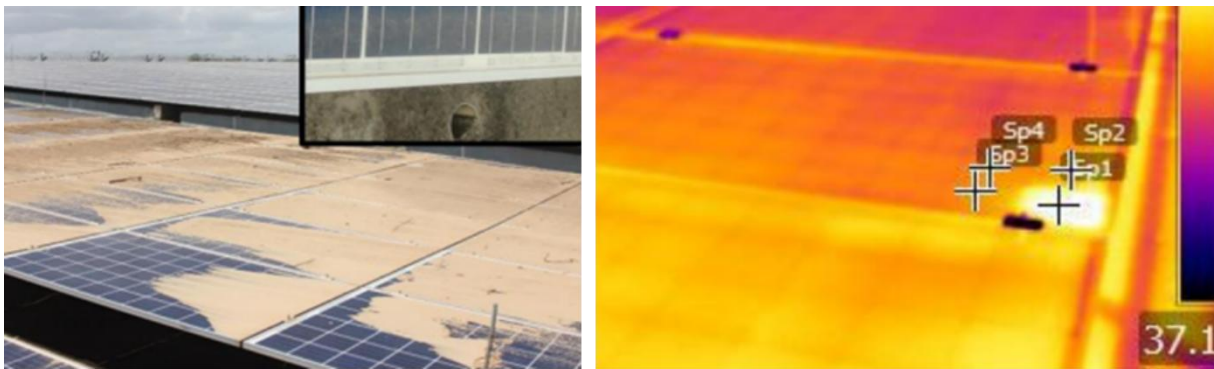
图33：洪水后的泥沙沉积导致模块永久性污渍，从而产生了热点。
