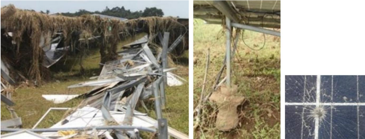
图29：印度南部因快速流动的洪水而受损的PV结构。例如包括被摧毁的组件和结构；被连根拔起的基座；以及被洪水碎片击碎的玻璃。
