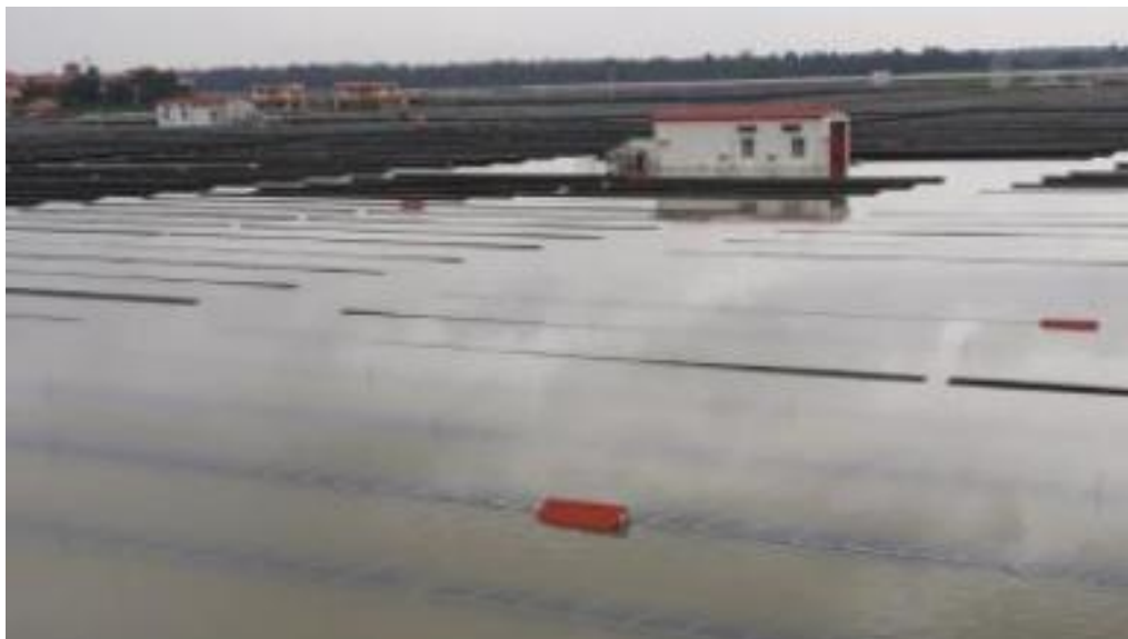
图31：在洪泛事件期间，光伏电站的部分区域被淹没在1-3英尺深的水中约两天。
