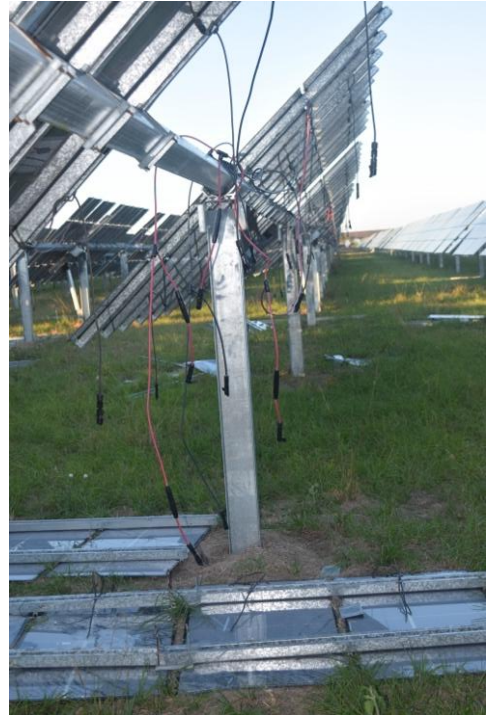
图6：2024年美国飓风海伦造成的损坏的跟踪系统显示。紧固件故障导致模块从扭矩管脱落并撕裂电气连接。 照片：L. Burnham。
